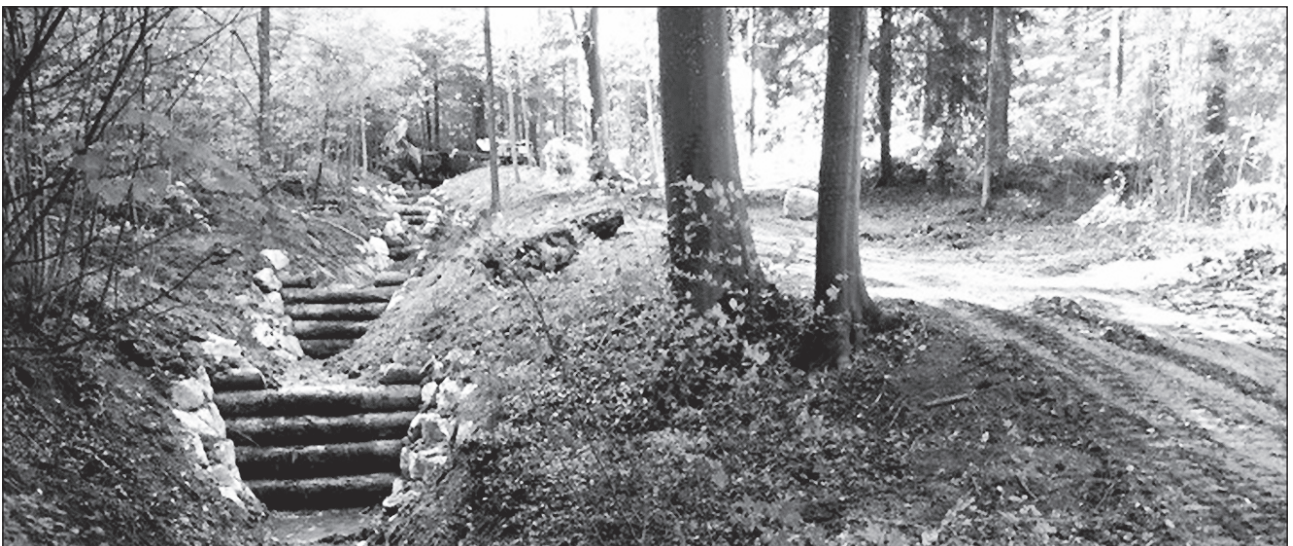
Die Verbauungen im oberen Teil des Döltschibaches: Die Spuren der schweren Maschinen sind rechts im Bild erkennbar.
